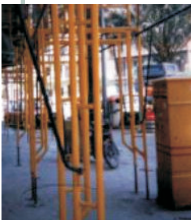
Imatge 40. Bastida que dificulta el pas dels vianants.
