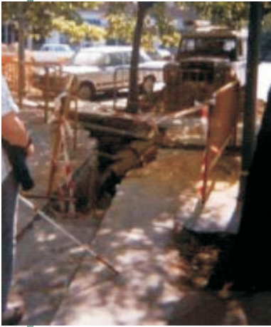
Imatge 38. Rases en obres sense la protecció adequada
